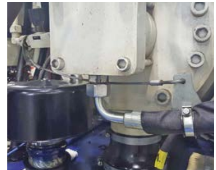
Abb. 2: Achtung, Fehler! Nicht richtig montierte Fangseilvorrichtung.
