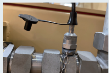
测压接头和测线
